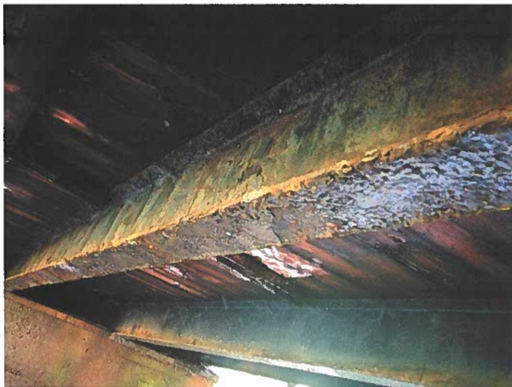
Fot. 5. Zniszczenie zabezpieczenia antykorozyjnego dźwigarów, korozja wżerowa pasów dolnych
