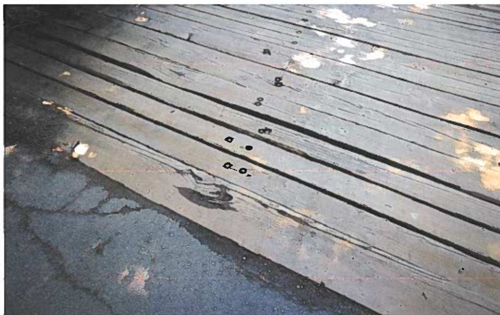
Fot. 2. Płyta pomostu z poziomu jezdni, widoczne ubytki, korozja i zanieczyszczenia belek pomostu, uszkodzenia łączników powodują klawiszowaniu belek podczas przejazdu, ubytki i spękania nawierzchni asfaltowej
