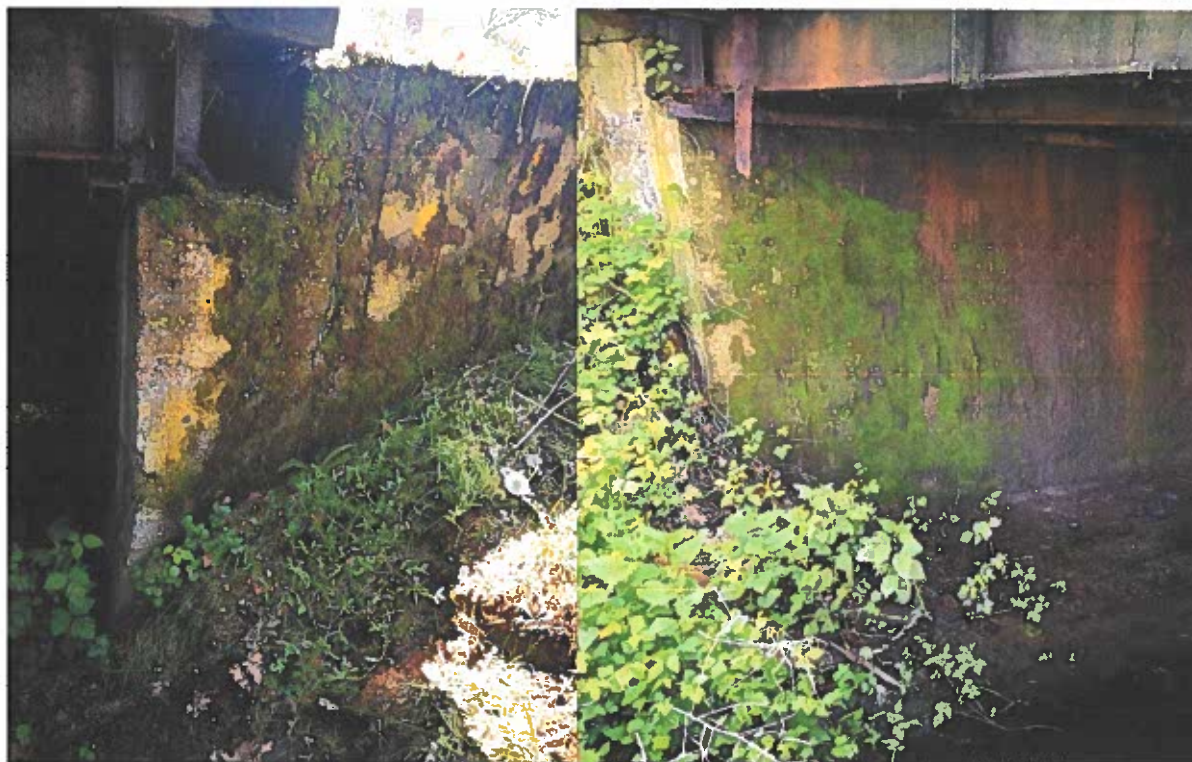
Fot. 3. Wegetacja roślinności na skrzydłach i ścianach przyczółków
