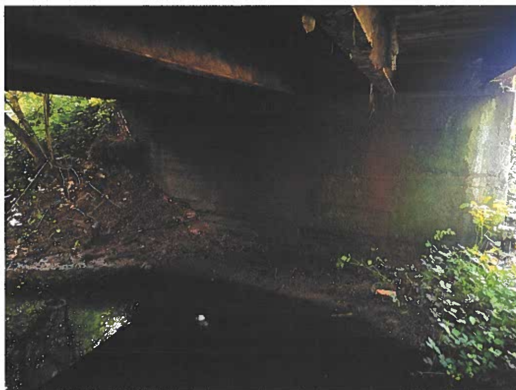
Fot. 6. Przestrzeń podmostowa, zawężenie koryta poprzez skarpe ograniczająca światło poziome pod obiektem.
