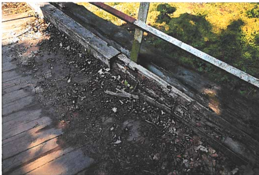
Fot. 1. Widoczne uszkodzenia belki krawężnikowej i belek pomostowych na skutek korozji biologicznej drewna
